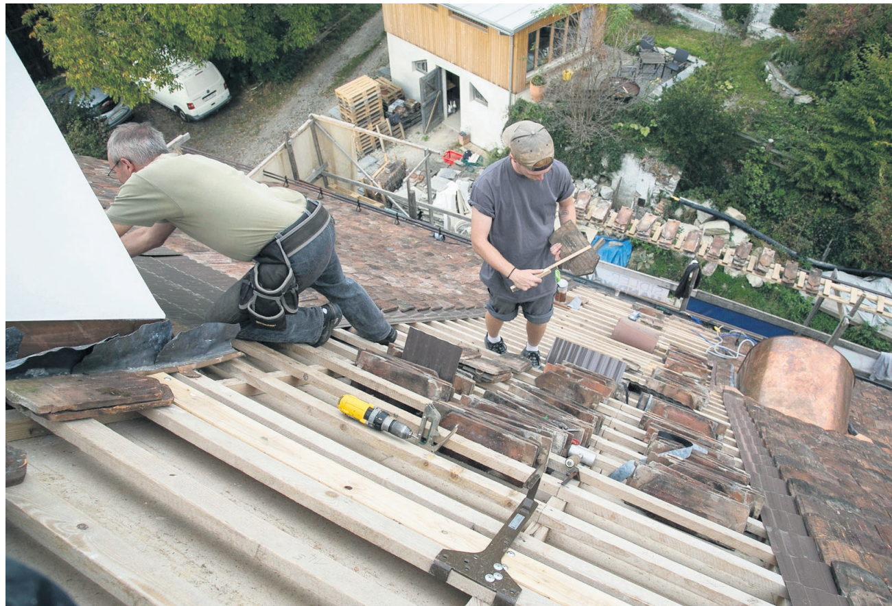
In luftiger Höhe an der Arbeit: Im Herbst wurde das neue Dach realisiert.
