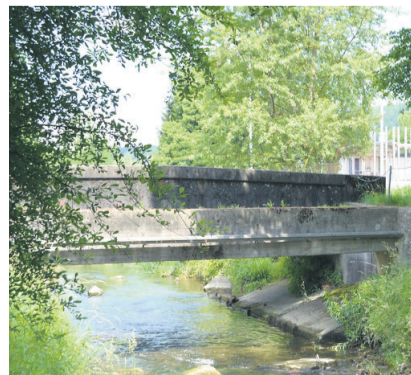
An der Brücke Rigackerstrasse sind die umfassendsten Sanierungsarbeiten nötig.
